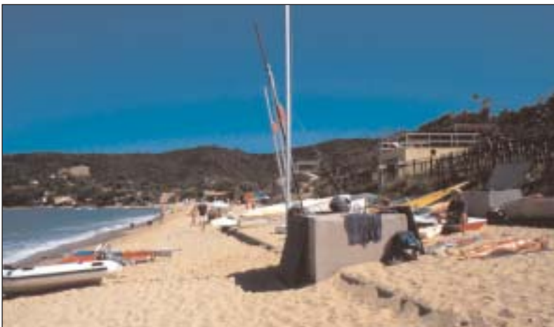
Il litorale di Procchio (Isola d'Elba) in cui si vede il pozzetto della condotta fognaria esposto dall'erosione; lo scaglino sulla spiaggia è dovuto alla presenza del tubo.
