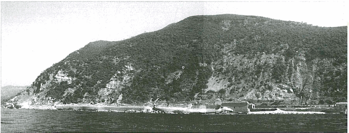
Figura 10 - Litorale Punta Rospo - Deiva Marina: le opere di presidio della ferrovia del litorale ligure mostrano lesioni legate all'erosione da parte dei mari di libeccio e di scirocco. L'attività delle frane in roccia del versante sovrastante ha subito un rallentamento in seguito alla costruzione di dette opere, ma l'apporto solido che arriva al mare, salvo rare eccezioni (a sinistra), è praticamente nullo.
