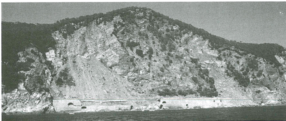
Figura 12 - Gli Apicchi: frane recenti del tipo crollo - valanga di detrito si sovrappongono alle rotture originarie, riconducibili a scivolamenti rotazionali regressivi. Le vecchie opere di presidio della ferrovia del litorale ligure svolgono un ruolo importante nell’evoluzione dei fenomeni franosi. L’interazione fra dinamica del versante, azione antropica ed erosione marina appare qui chiara.
