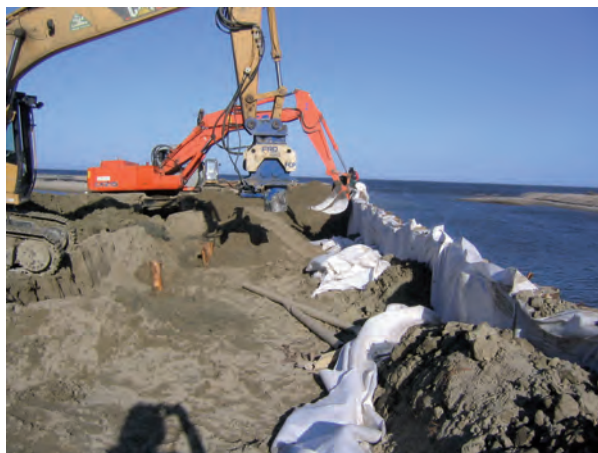
Figura 9 - La posa in opera del geotessile a tergo della palificata in legno nella zona della nuova foce.
