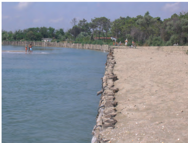
Figura 13 - Le opere di protezione della nuova foce e la gaveta. Vista da mare verso terra.
